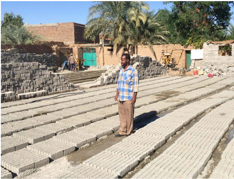
Ein Dorfbewohner arbeitet bei der Herstellung von Ziegeln für die Erneuerung der Bewässerungskanäle mit. © DEZA
