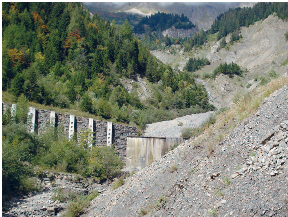
Sperren im Lammbach (Gemeinde Schwanden) und aufgeforstete Hänge haben die Murganggefahr reduziert. Quelle: M. Zimmermann
