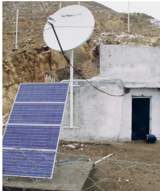
Eine Erdbebenüberwachungsstation mit einer Breitbandsatellitenverbindung in Shartuuz, Tadschikistan. Quelle: PMP International, Tadschikistan
