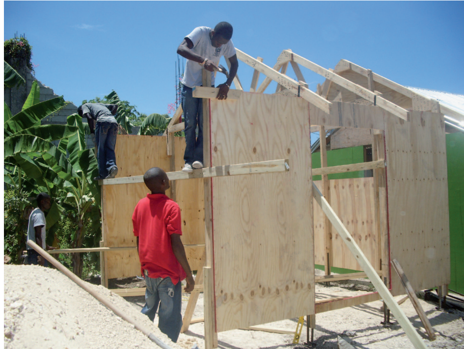
Das Centre de Compétences Reconstruction bietet Beratung für den Bau von temporären Unterkünften an. Quelle: DEZA Programmbüro Port-au-Prince, Haiti
