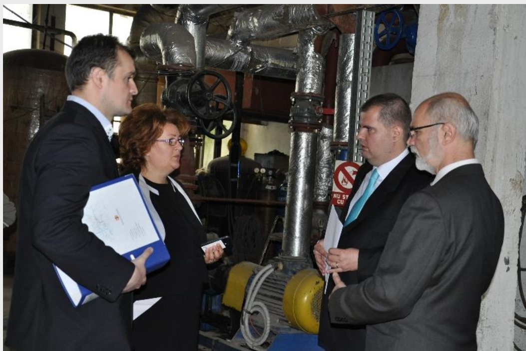
Domnul secretar de stat Gyorgy Attila (al treilea din stânga) vizitează municipiul Arad cu privire la proiectul privind reabilitarea rețelei de transport și distribuție a energiei termice ©SCO
