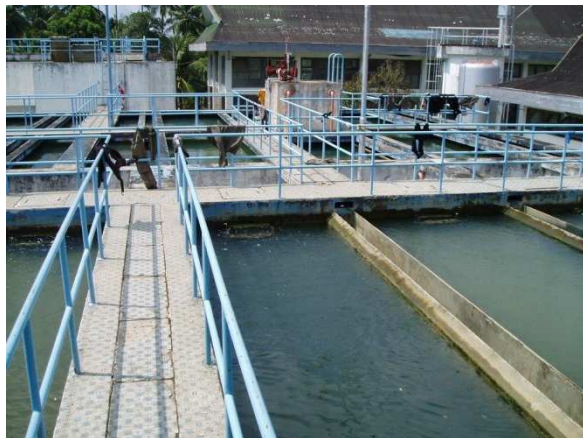
Il ripristinato impianto di potabilizzazione di Lambaro (Banda Aceh) fornisce acqua potabile agli abitanti. ©DSC
