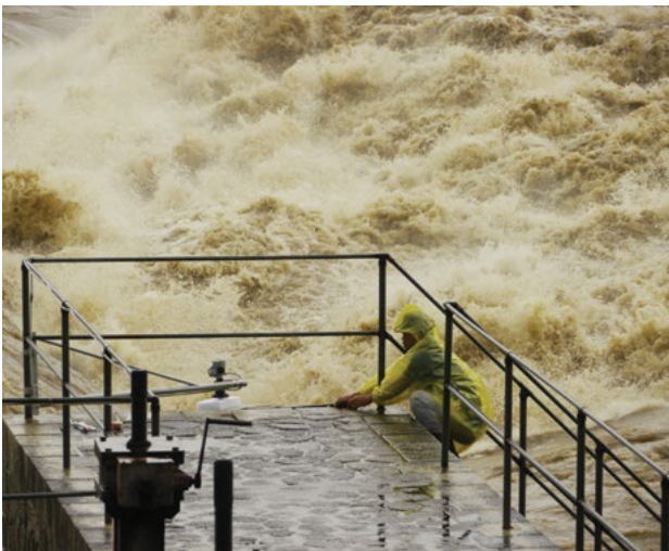
Kỹ thuật viên kiểm tra bộ phận cảm biến đo mực nước thuộc hệ thống cảnh báo sớm do GIZ hỗ trợ tại tỉnh Phú Yên
